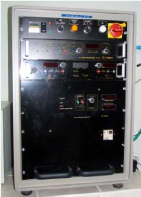
เครื่อง RF Generator
